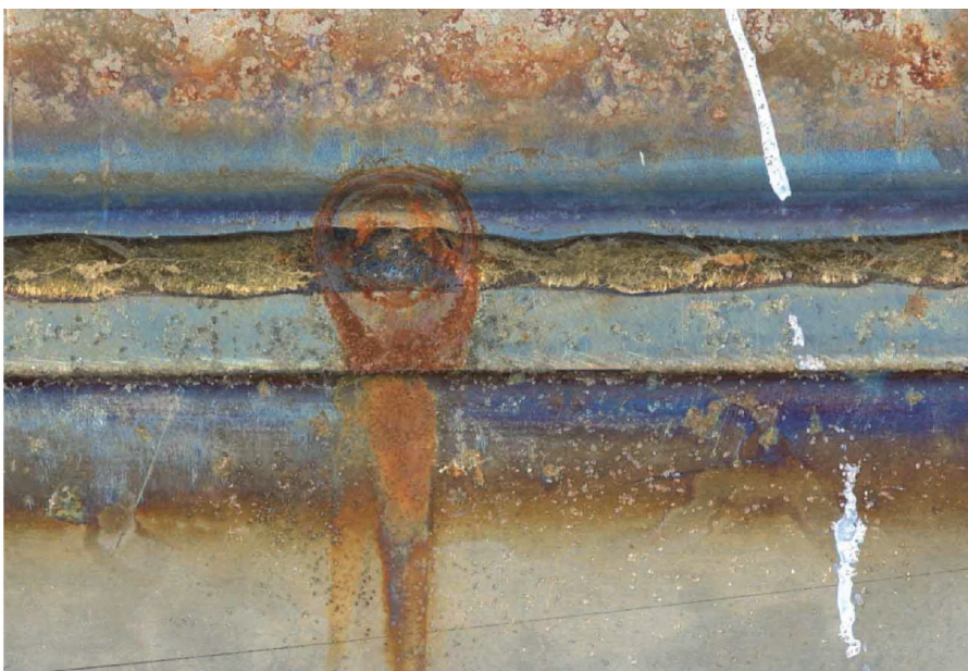
Abbildung 14: Anlauffarben und bereits erfolgte Korrosion durch nicht geeigneten Gasschutz
